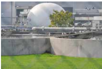
Purification artificielle Mouscron Rioolwaterzuiveringsinstallatie Mouscron
